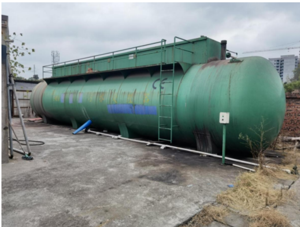
图 2-1 湖南利农五倍子产业发展有限公司污水处理站
