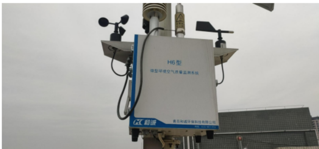
图 2-1 大气环境监控预警系统——小微站
