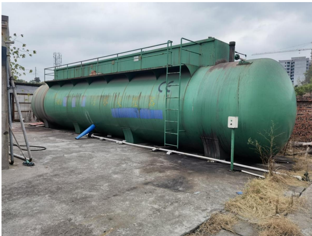
图 2.1-1 湖南利农五倍子产业发展有限公司污水处理站
